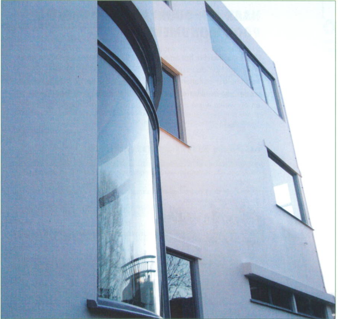
Figuur 8 Geveldetail Chabotmuseum, Van Ruysdael museumglas in stalen kozijn. Foto Van Ruysdael
